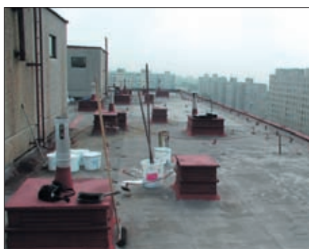
Stav střechy před aplikací hmoty SANAKRYL TOP (UV)
